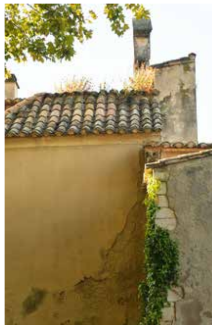
Le développement de nombreux végétaux, sur le toit et la façade nord, et l'absence de relevé d'étanchéité et de gouttière, concourent au désordre lié aux entrées d'eau
