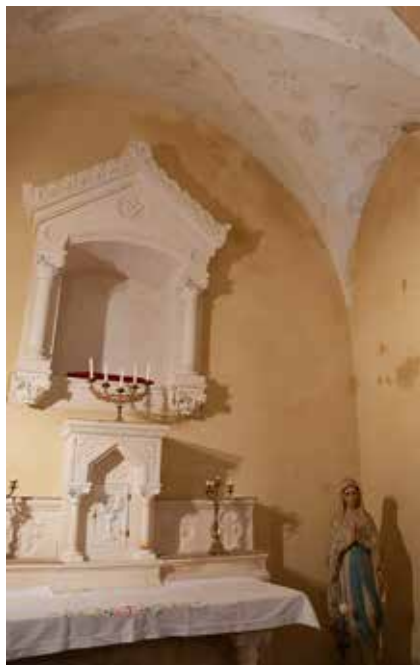
Sur la chapelle latérale nord, là aussi, de nombreuses tâches et décollements sont observés, sur la voûte et les parois
